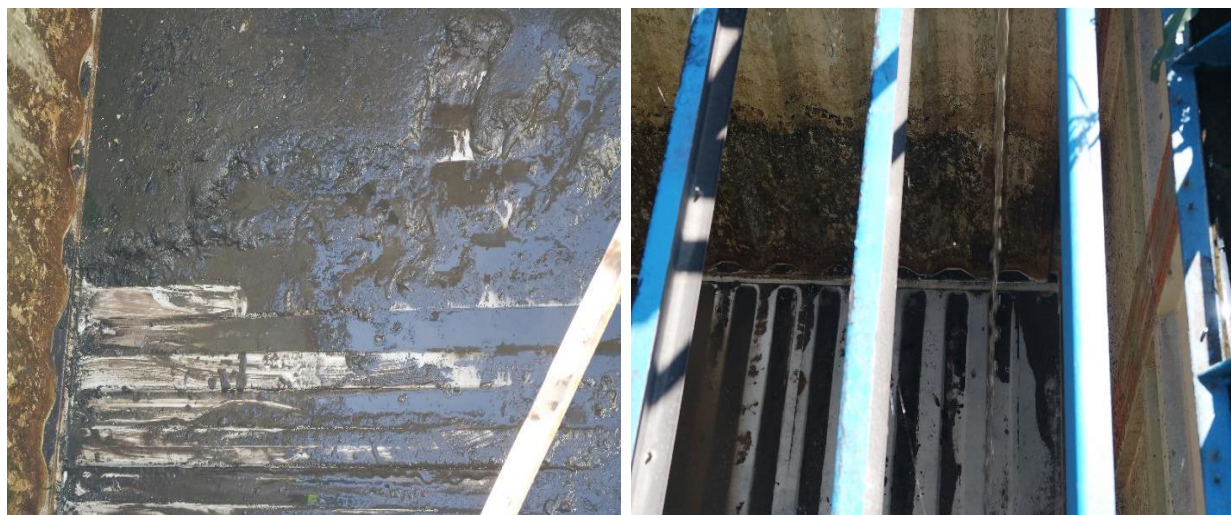
Рисунок 2. Откачка загрязненной воды и очистка камер (1 камера-слева, 3 камера-справа) резервуара-отстойника самонапорной системы капельного орошения на ОПУ КХ «Нуржан» в Меркенском районе Жамбылской области
